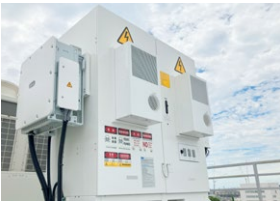
リチウムイオン型蓄電池（草加工場）
