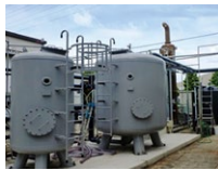
中水設備（草加工場）
