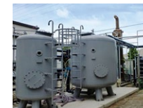
中水設備（草加工場）
