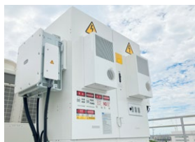
リチウムイオン型蓄電池（草加工場）
