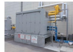
自然冷媒（アンモニア/CO 2 ）を使用した冷凍機（理研食品）
